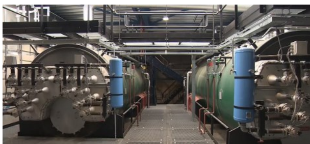
In de biomassacentrale
