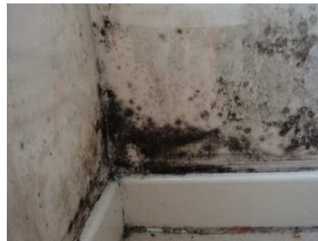
Schimmel op de muur
